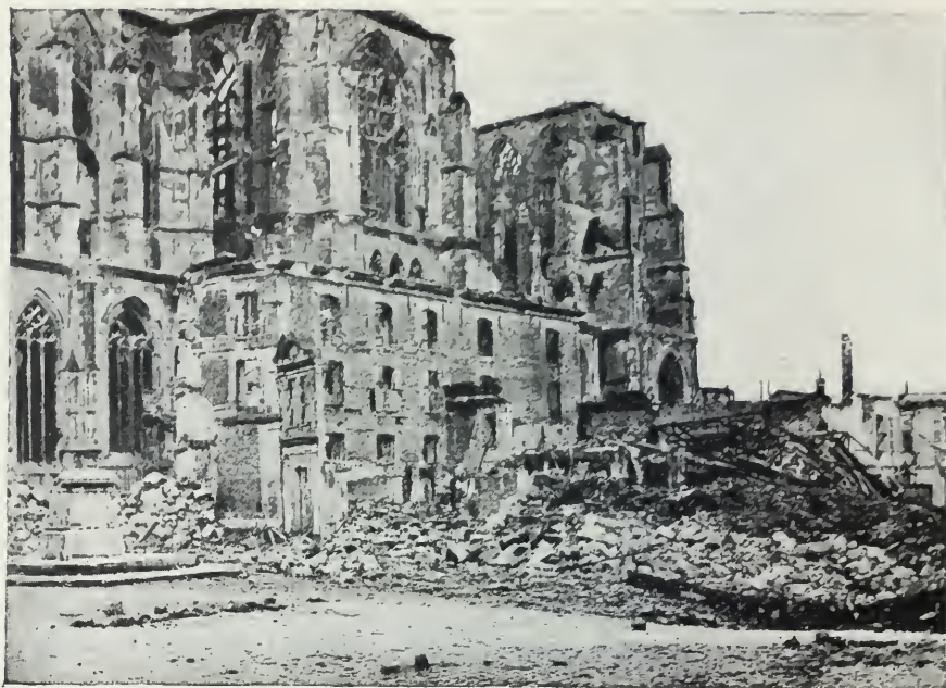
LA COLLÉGIALE. — LE COTÉ SUD. (OCTOBRE 1918.) La statue de Quentin de La Tour a disparu de son socle. Les bâtiments s'appuyant à la basilique sont écroulés.
